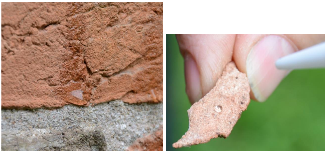
Fig. 1. Het baksteenmetselwerk van de NH kerk te IJsselstein is hydrofoob op diverse plekken.
