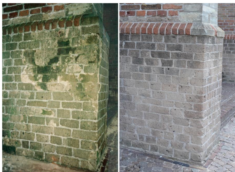
Fig. 2. Twee foto's van het tufstenen basement van een steunbeer aan de NH kerk te Oudewater. Links: foto uit het rapport uit 1994 met duidelijke schade aan de steen. Rechts: situatie 2018 met teruggehakt en hervoegd tufsteen oppervlak.
