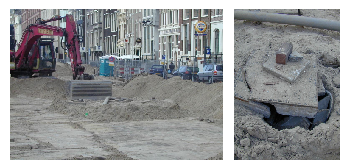
Figuur 3.31; Werkzaamheden t.p.v. panden die aan de oostzijde het toekomstige station zijn gelegen. Tijdens de werkzaamheden is een beschermbuis van een meetinstrument zwaar beschadigd (foto's afkomstig van R. de Nijs van Adviesbureau Noord/Zuidlijn).
