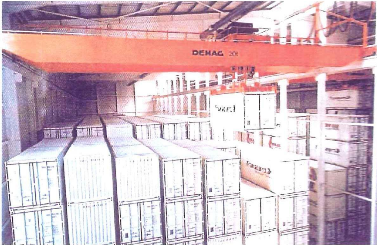
Figuur 5.23 Ondergrondse opslag van koelcontainers
