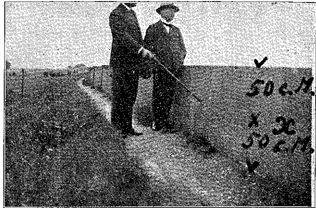
Fig. 51 Een 16 jaren geleden met beton opgehoogde betonmuur (50 c.M.)
