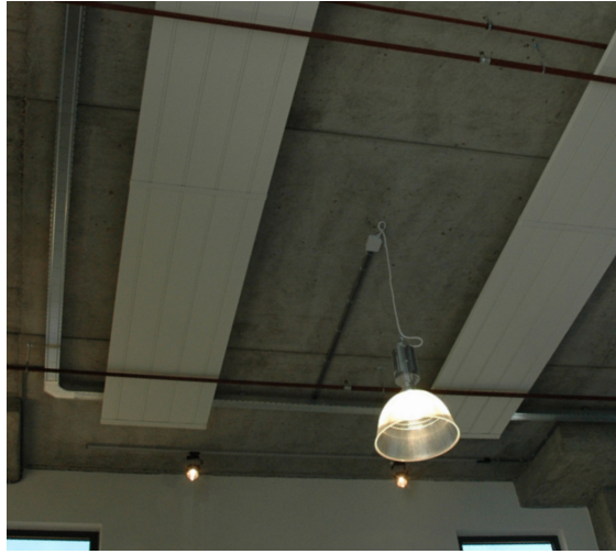
Figuur 29 Stralingspanelen, zoals deze panelen aan het plafond van The Village Office in Houten, kunnen zowel worden ingezet voor (lage temperatuur)verwarming als (hoge temperatuur)koeling, daarbij energie-efficiënter dan conventionele systemen. Stralingswarmte wordt als behaaglijker ervaren dan verwarmings- of koelsystemen gebaseerd op convectie (bv. luchtverwarming of -koeling)
