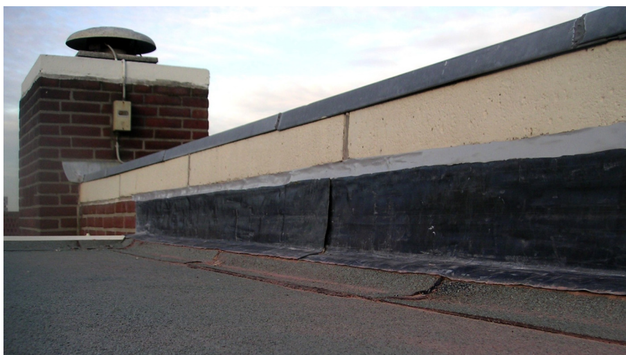
Figuur 22 Dakrandaansluitingen, zoals deze met een loodslabbe en silconenkit, kunnen reden zijn van lekkages en vochtplekken in een gebouw
