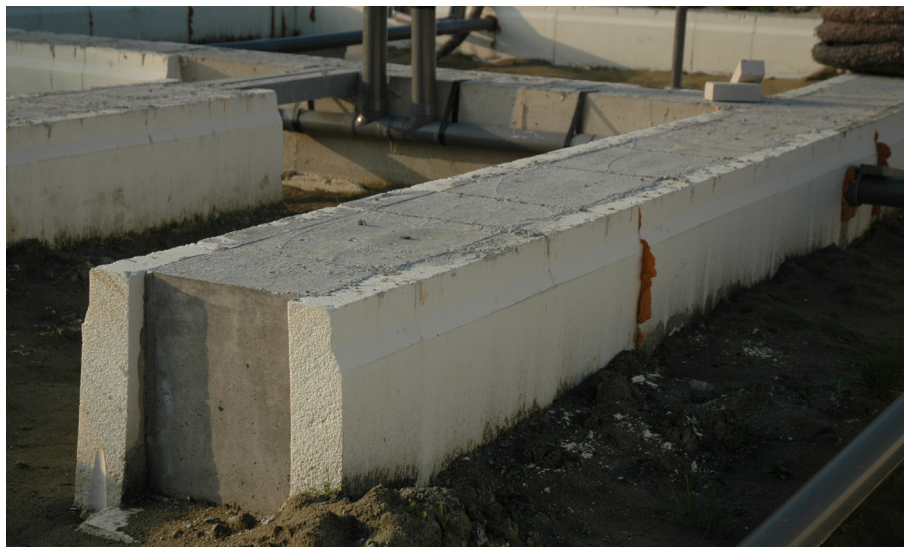
Figuur 34 Het gebruik van isolatiemateriaal (hier: EPS) als 'verloren bekisting' maakt het gebruik van bekistingsplaten overbodig en bespaart energie doordat er minder warmtetransmissieverliezen optreden door de funderingsbalken
