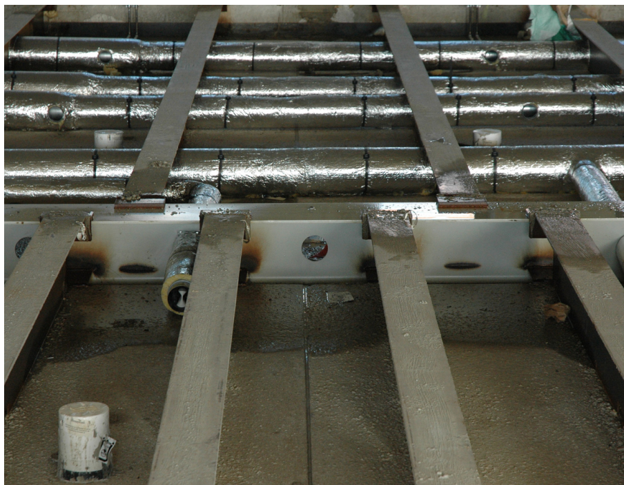
Figuur 15 In de constructie van het nieuwe brandweerkazernegebouw/gemeentekantoor in Delft is een zogenaamde wingvloer toegepast, opgebouwd uit betonplaten, stalen liggers en een afdekking met betontegels. In de verhoogde vloer worden alle leidingen gelegd. Die kunnen daarom gemakkelijk worden gerepareerd, aangepast of vervangen.
