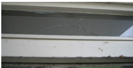
Figuur 4.4-j gebroken ruit boven galerijdeur
