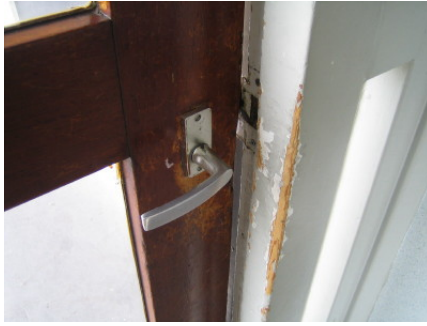
Figuur 4.4-k beschadiging galerijdeur en deurpost
