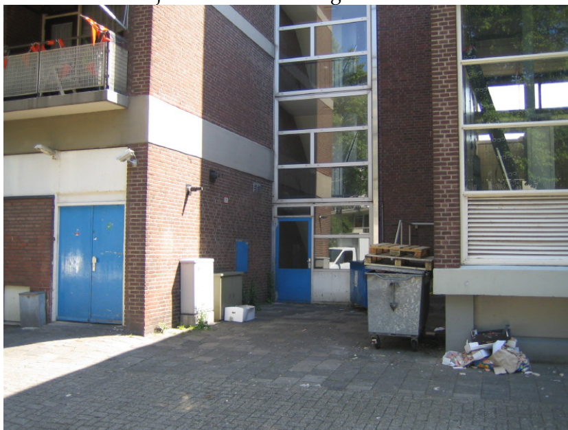
Figuur 4.5-m Rotzooi van winkels bij de ingang van het noodtrappenhuis aan de achterzijde van de Reigerflat
