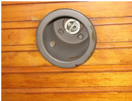
Figuur 4.4-i 'plafondverlichting' centrale entreehal
