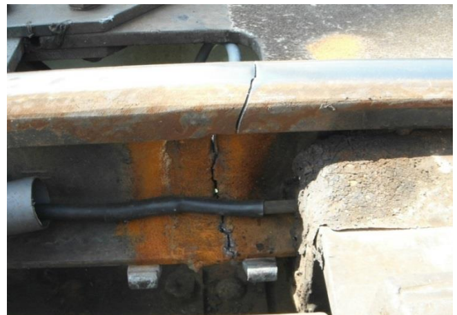
Figuur 2 Breuk van een lasverbinding in ingegoten spoor
