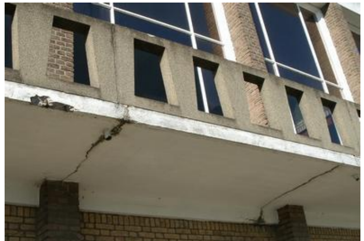
Figuur 8-3 Scheuren ten gevolge van verhinderde temperatuurvervorming. Bron: [4]
