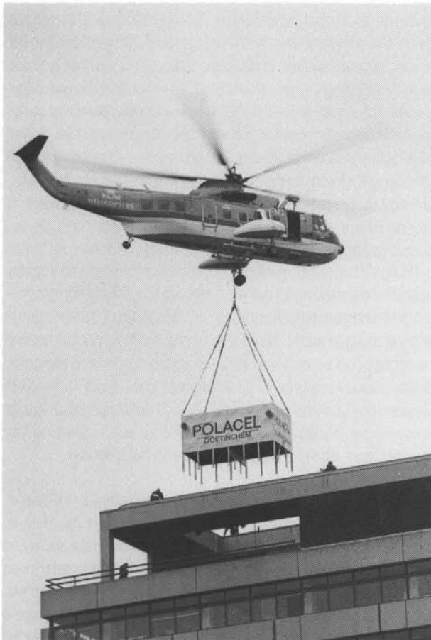
5.19. De gebruiksduur van installaties is korter dan die van andere bouwkundige componenten. Vervanging vraagt soms inventieve oplossingen.
