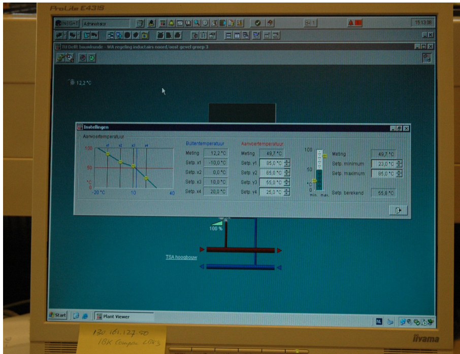
Figuur 22 Gebouwbeheersysteem dat de klimaatinstallaties aanstuurt
