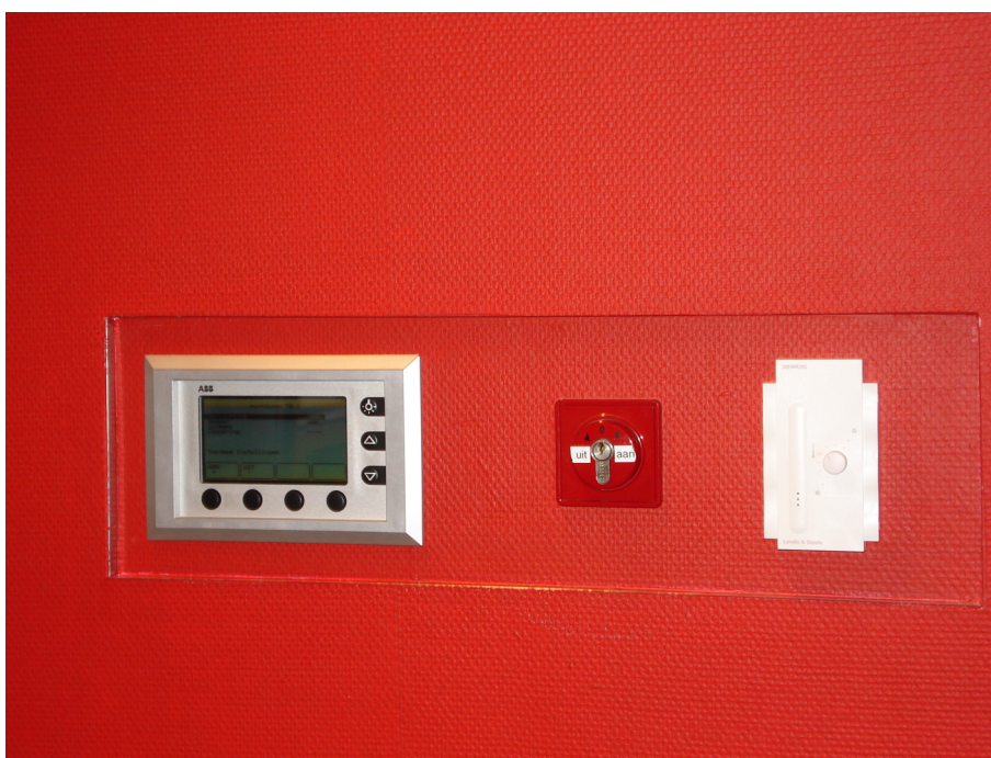
Figuur 63 Ruimtethermostaat (rechts) en een bedieningspaneel voor verlichting, doeken en zonneschermen (links) in de instructie- en tutorruimten in het westelijke lage blok
