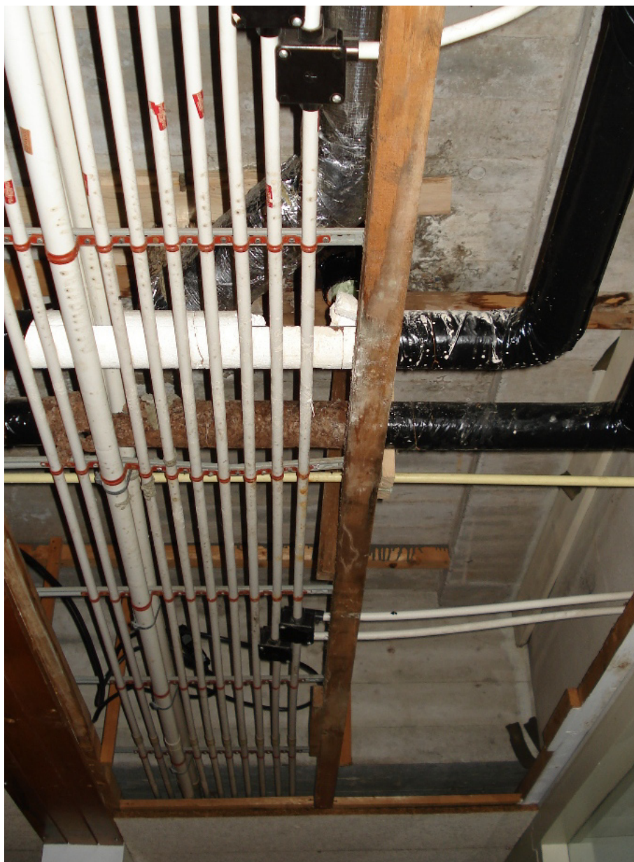
Figuur 59 Opengewerkt plafond: alle leidingen voor elektriciteit, waterafvoer, watertoevoer en centrale verwarming hangen onder de betonvloeren en zitten verstopt achter de plafonplaten
