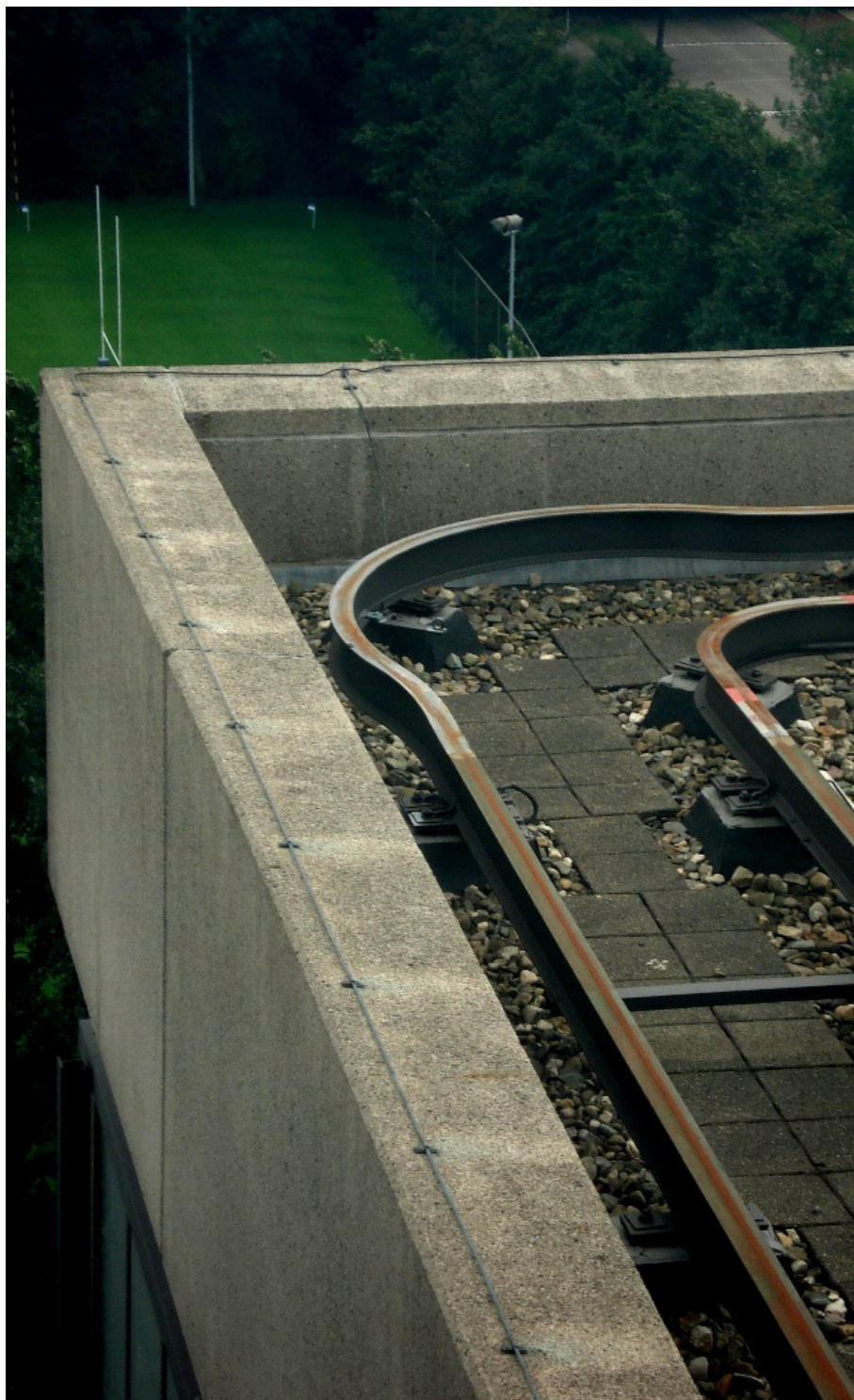
Figuur 24 Rails op het dak van de hoogbouw voor gondelininstallatie
