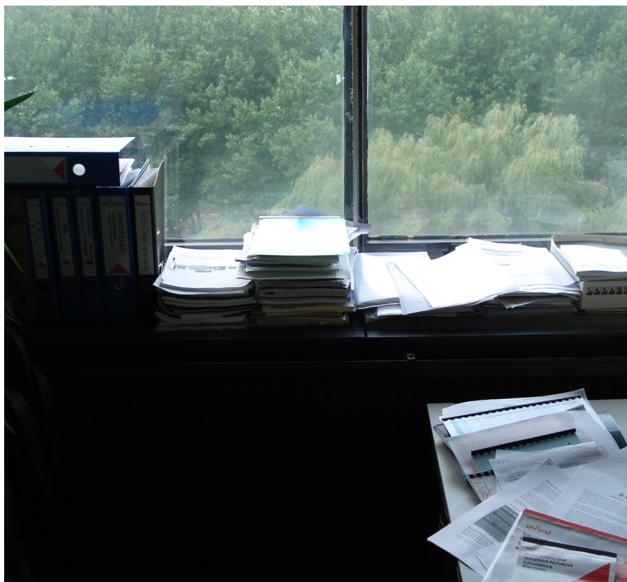
Figuur 67 Papierwerk op ventilatieroosters in kabinetten, verse luchttoevoer wordt belemmerd
