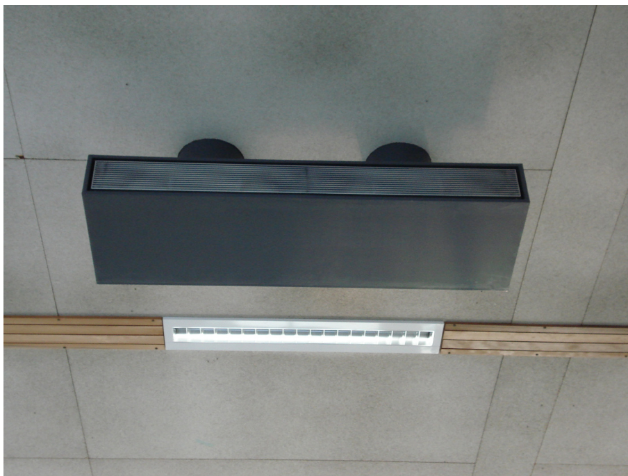
Figuur 62 Inblaasunit voor ventilatielucht in een atelier; koeling vindt plaats in de schacht naar deze unit
