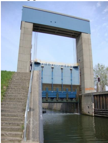
Figure 65 lifting gate, www.debinnenvaart.nl
