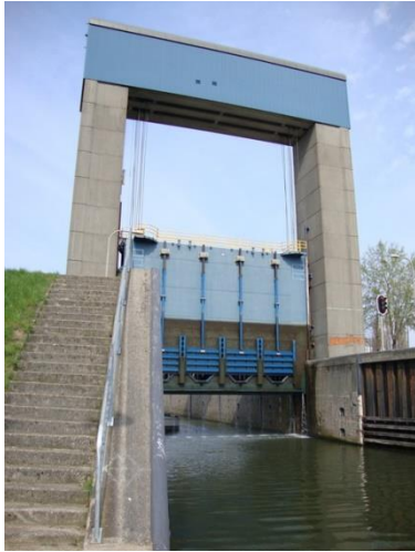
Figure 11 lifting gate, www.debinnenvaart.nl
