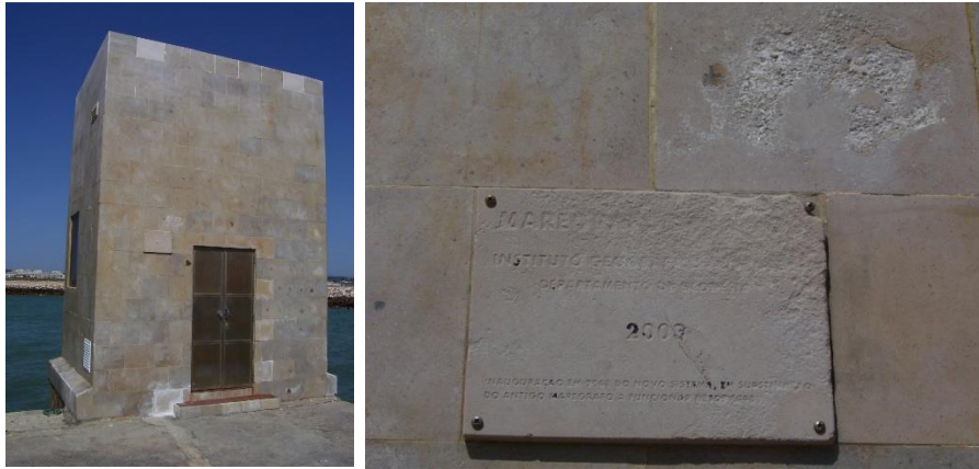
Fig. 9. Zoutschade aan een in 2003 geplaatste kalkstenen plaquette en gevelbekleding van een gebouwtje in de haven van het Portugese Lagos. De foto is slechts drie jaar later genomen.
