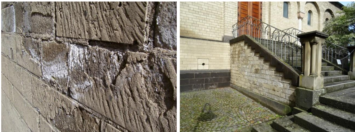
Fig. 7 (vervolg). Voorbeelden van zout schade. Bovenste rij: zout schade aan pleister, Suur-Klooster, Tallinn (2005). Onderste rij: Afspringen van Weiberner tuf, St. Maria im Kapitol, Keulen (2009 & 2017).
