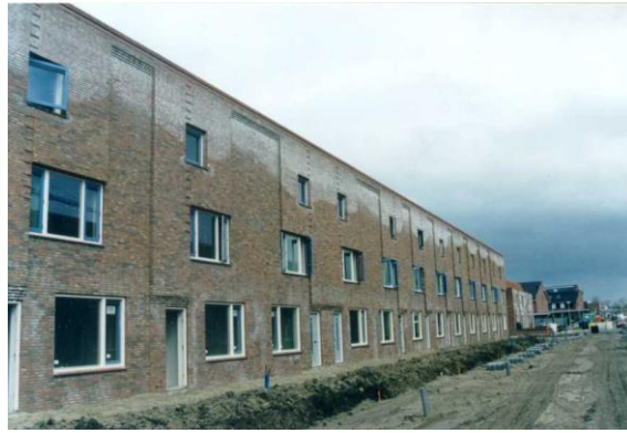
Fig. 4. Vroege sulfaatuitbloei op metselwerk vlak na uitvoering.
