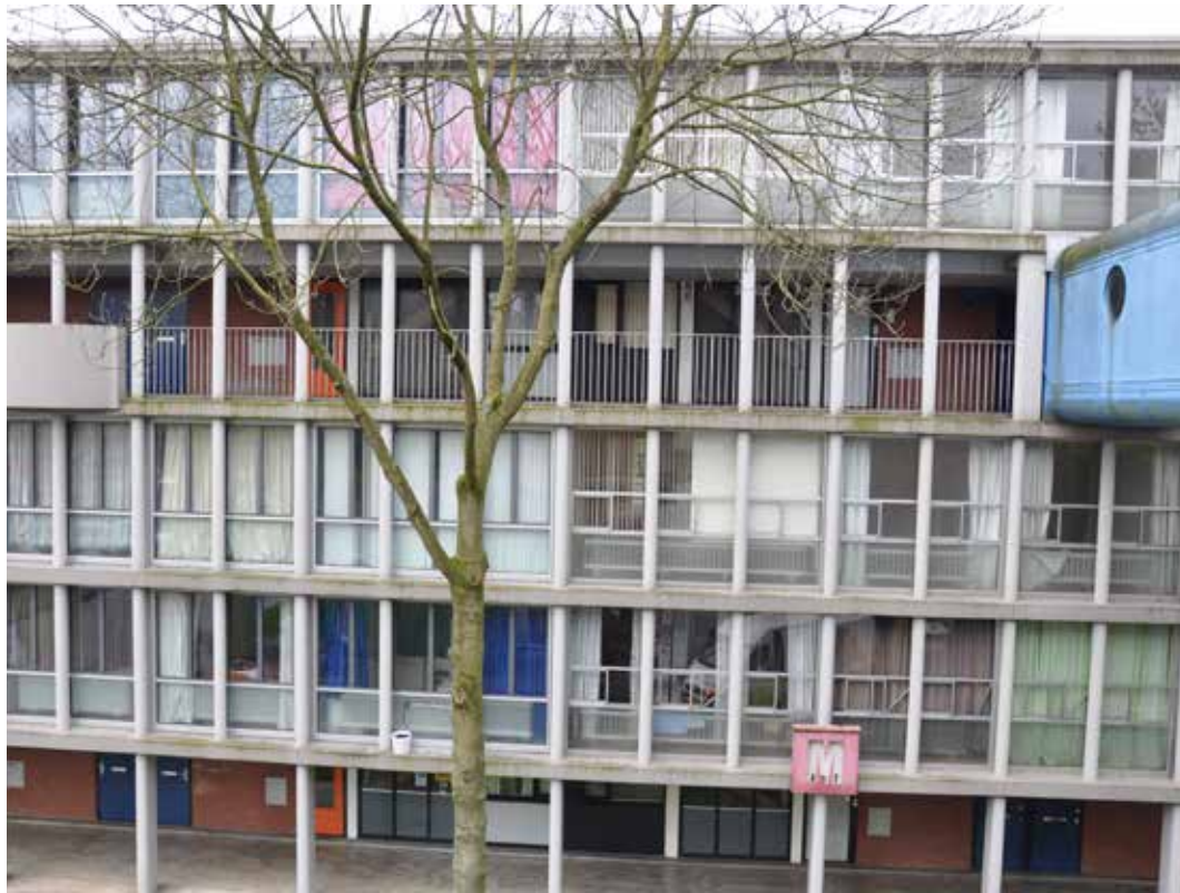
AFBEELDING 10.3 Het Breed. Links van de boom zijn de kozijnen al vervangen, rechts nog niet.
