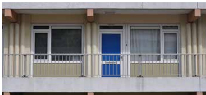
AFBEELDING 8.155 Na de renovatie zijn kunststof kozijnen toegepast. Keuken en slaapkamer hebben nu een draaikiëpraam, een vast beglaasd raam met ventilatierooster en een bovenlicht. De halfronde verticale elementen zijn deels voor leidingen (HWA). Bron tekening: Gemeentearchief Rotterdam.
