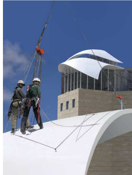
FIG. 131 Alpinistmonteurs van Octatube bezig op een volgende schaal met op de achtergrond de beide gemonteerde schalen van de Library
