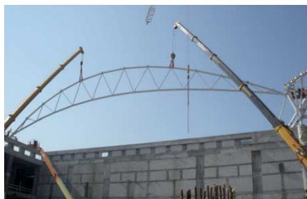
FIG. 29 Assemblage van de complete stalen spanten met twee mobiele kranen voor Cotroceni in Boekarest
