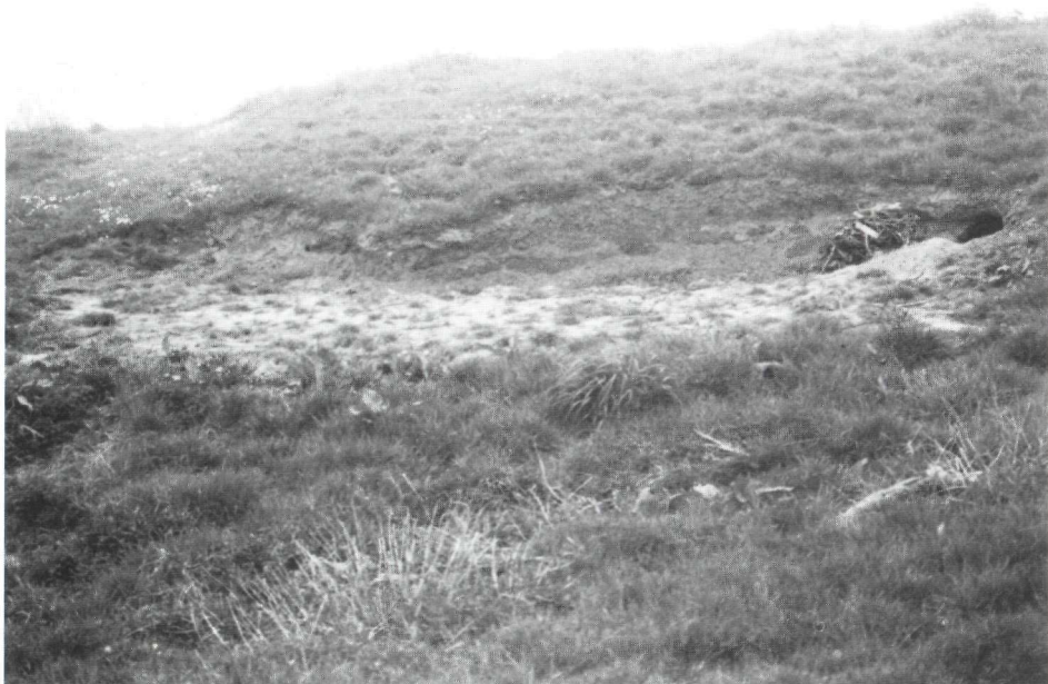
Foto nr. 66 Ws Oost-Veluwe Linker IJsselbandijk, Stadsland (Deventer) (hmp 289): Erosie en graverij aan het buitentalud. Situatie na hoogwater.
