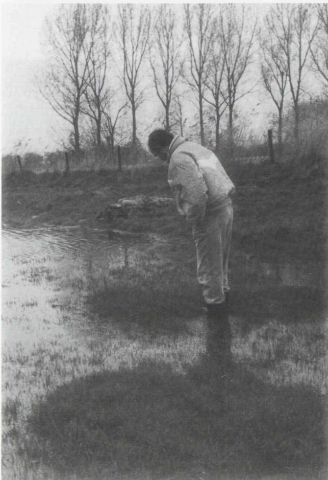
Foto nr. 42 Pd Groot Maas en Waal Linker Waalbandijk (dp 60): Illustratie van „water- blaar”. Door betreding treedt veel water uit van onder de opgedrukte grondlaag. Situatie tijdens hoogwater.
