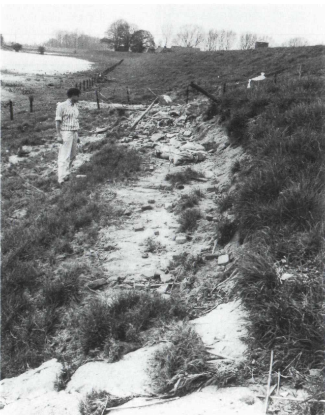
Foto nr. 8 Pd Betuwe Rechter Waalbandijk (hmp (O) 278,5): Ernstige erosie aan een buitendijkse afrit. Verdediging met behulp van puin. Situatie na hoogwater.
