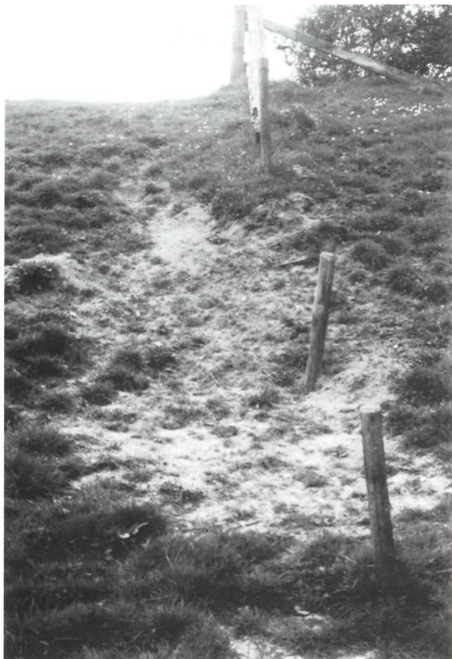
Foto nr. 65 Ws Oost-Veluwe Linker IJsselbandijk (hmp 286): Erosie buitentalud door betreding van vee. Situatie na hoogwater.
