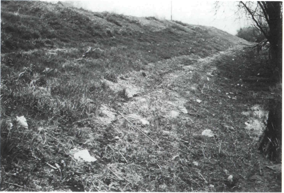
Foto nr. 5 Pd Tieler- en Culemborgerwaarden Rechter Waalbandijk (hmp 16,5): Stroomerosie aan buitentalud. Situatie na hoogwater.
