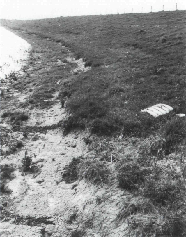
Foto nr. 7 Pd Betuwe Rechter Waalbandijk (hmp (0) 198-200): Erosie buitentalud. Oorzaken: stroming en muskusratten. Situatie na hoogwater.
