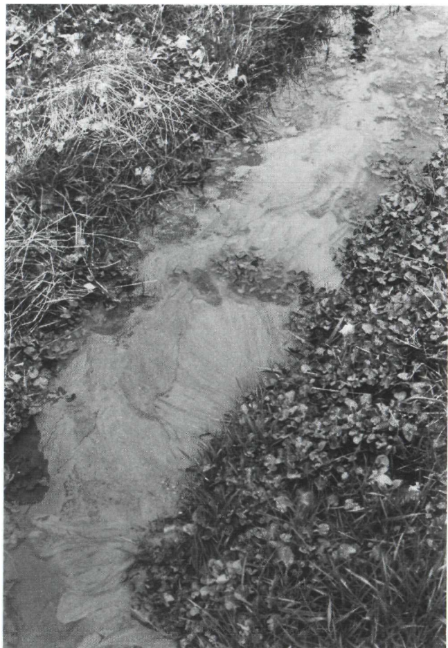
Foto nr. 24 Ws Oost-Veluwe Linker IJsseloever, zomerkade Wilpsche Kleipolder: Detail: Wel in sloot op de hoek van de Nijenbeekseweg en de Houtwalstraat. Situatie tijdens hoogwater.
