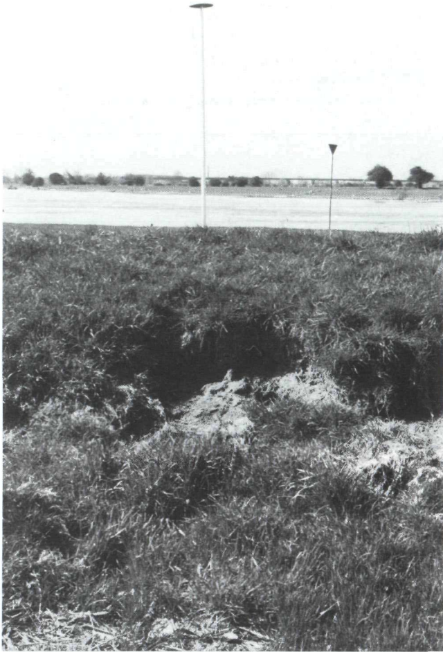
Foto nr. 67 Pd Rijn en IJssel Rechter IJsseloever, Lathumse kade: Schade ten gevolge van graverij door dieren en overlopen (zie ook foto nr. 48). Situatie na hoogwater.
