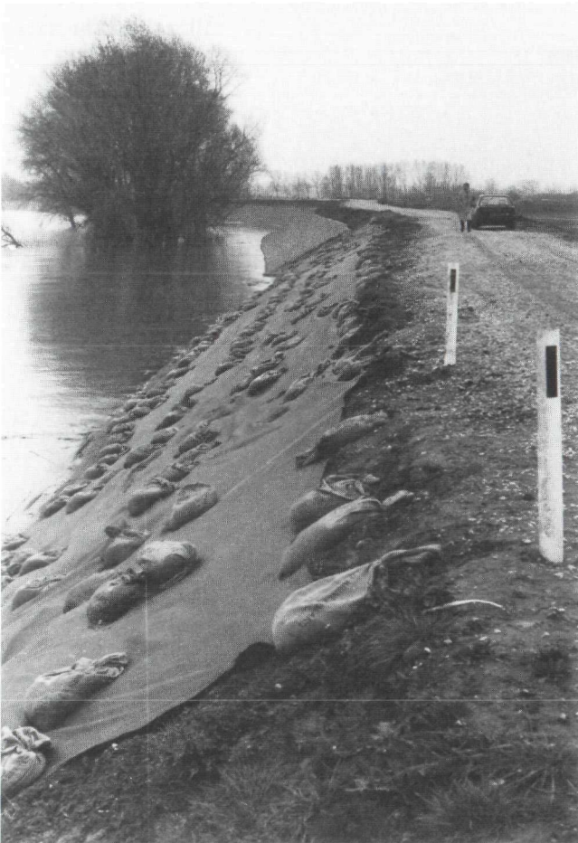
Foto nr. 12 Pd Groot Maas en Waal Linker Waalbandijk te Oenssel (hmp 53): Met kunststofdoek beschermd „nieuw” buitentalud. De bekleding (basalton) was niet gereed voor winterseizoen. Situatie tijdens hoogwater.
