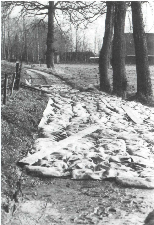
Foto nr. 37 Ws Oost-Veluwe Linker IJsselbandijk (rkm 955): Verweking en opbarsten van een binnendijks weggetje. Verzwaard middels doek en zand- zakken. Situatie tijdens hoogwater.
