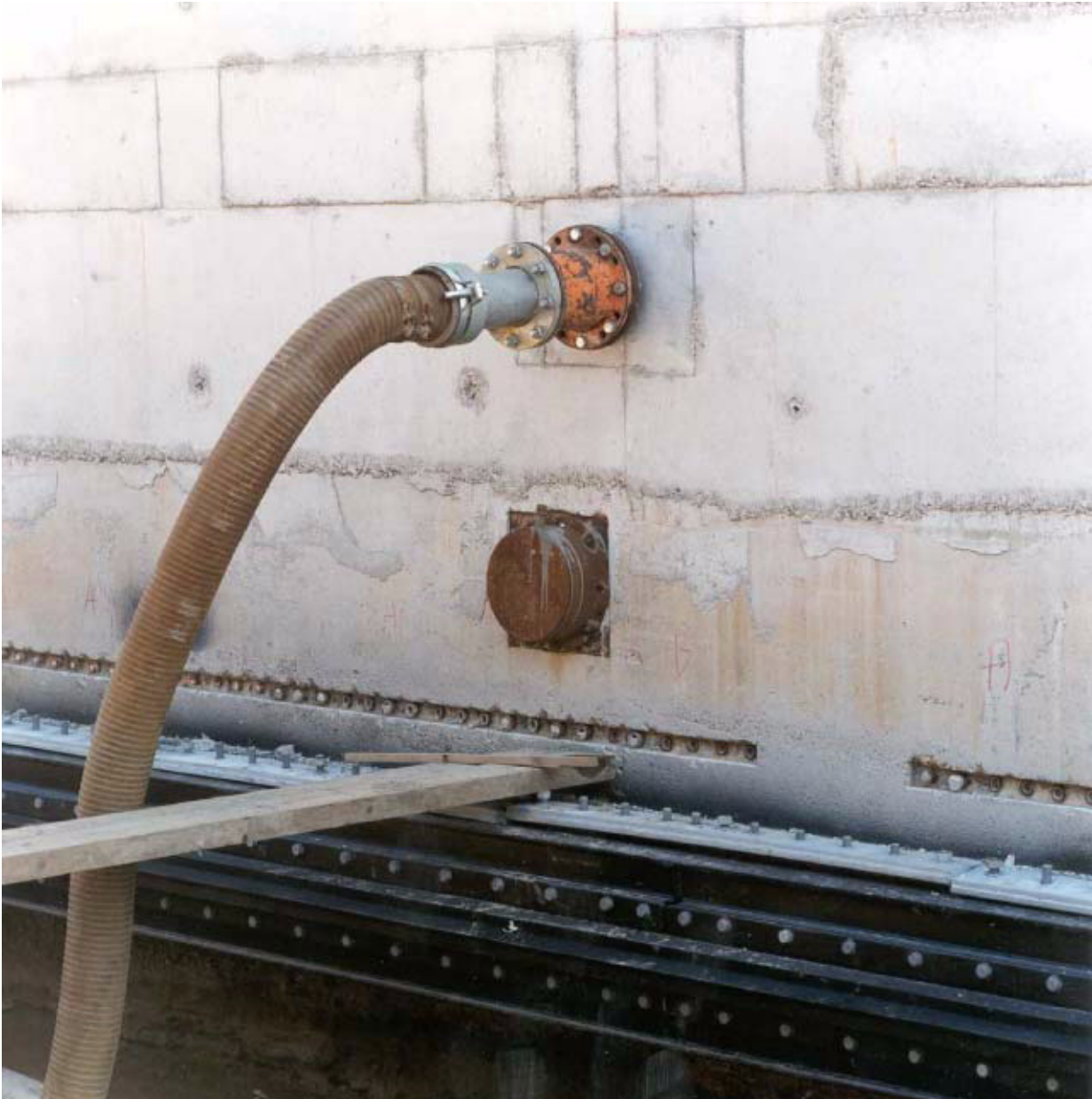
Afbeelding 8.8.8, Doorvoer tot ballastleidingssysteem.
