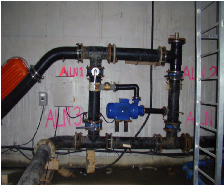
Afbeelding 5.8.4, Ballastleidingensysteem Calandtunnel ( afsluiters, een centrifugaalpomp en de in- en uitstroomleidingen)
