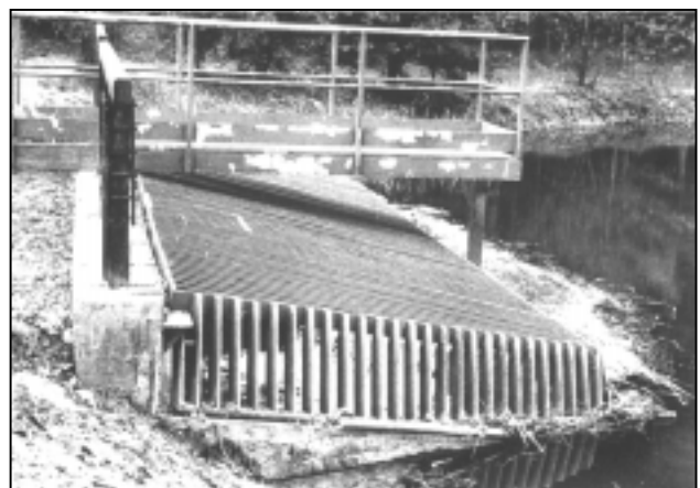
Figure 20.1.3.b - Example of protective grid (Amt der Steinmarkischen Landesregierung – Fachabteilungsgruppe Landsbaudirektion – Fachabteilung IIIa – Wasserwirtschaft – 1994)
