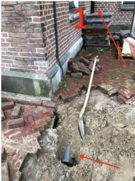
Foto 9: HWA loopt van achter bij de muur (1) naar de put toe. Afgebroken hemelwaterafvoer (2).
