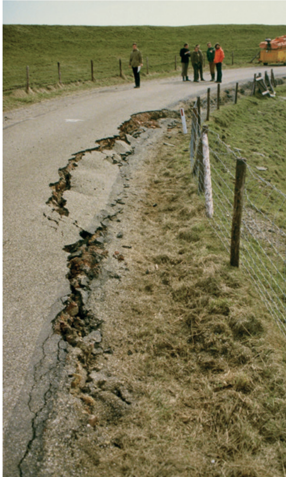
Figure 1. Failure of dike in North Holland, polder Beschoot (Photo courtesy Beeldbank Rijkswaterstaat beeldbank, Hein Versteeg).
