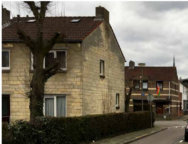
D.05 Vijftigerjaren woningen met mergel in de gevel aan de pastoor Sartonstraat te Valkenburg (W.J. Quist 2017).
