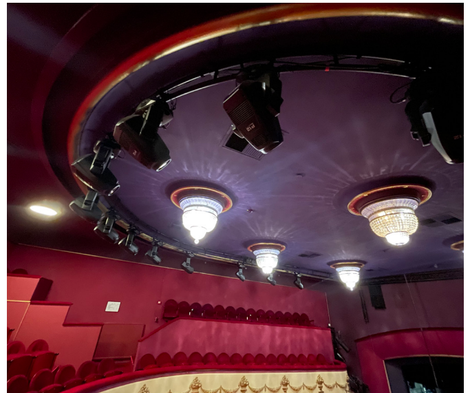
Figuur 5.5 - Lichtinstallaties in de zaal
