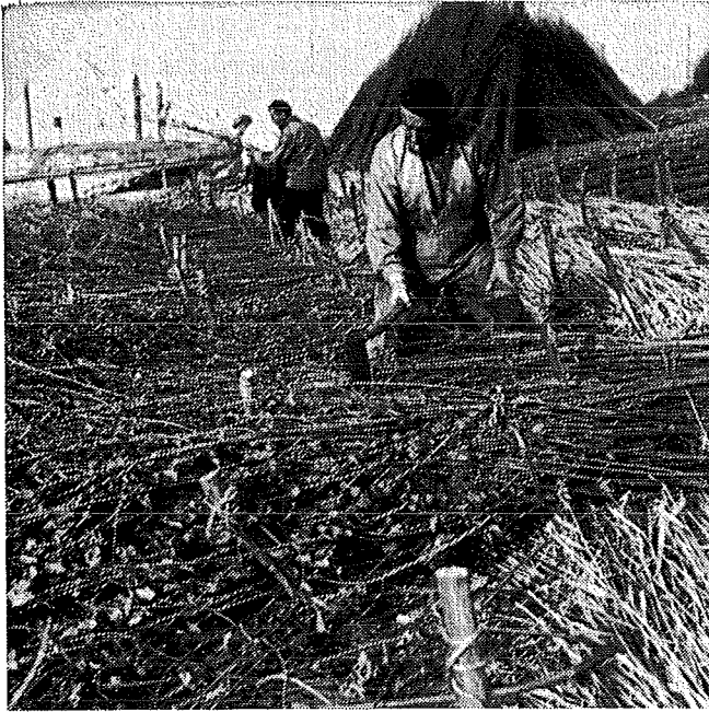
Fig. 176. Het losmaken dan wel spreiden van bossen Gelders hout. Hieronder de rietlaag.
