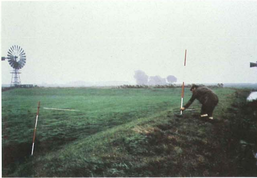
Overzicht schade boezemkade met achterliggend polderland.
