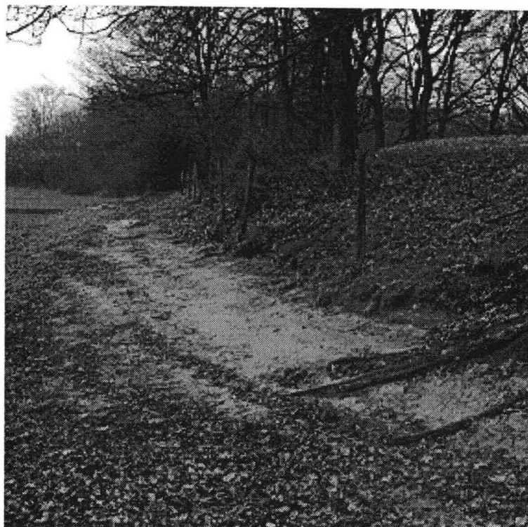
Figuur 6.3 Erosie buitentalud Bomendijk in januari 1995
