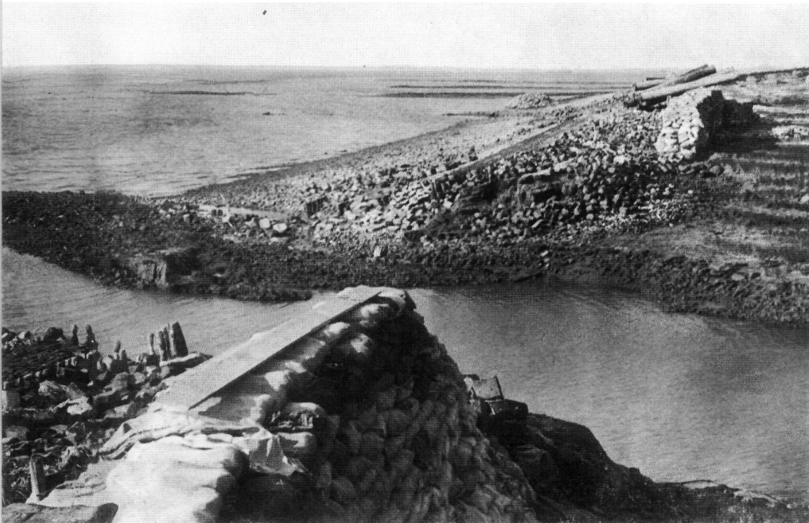
fig. 103. Dijkdoorbraak in de polder Stavenisse (1953), voorlopig gedicht door een ringkade van zakken klei, deels afgedekt met zeilen.
