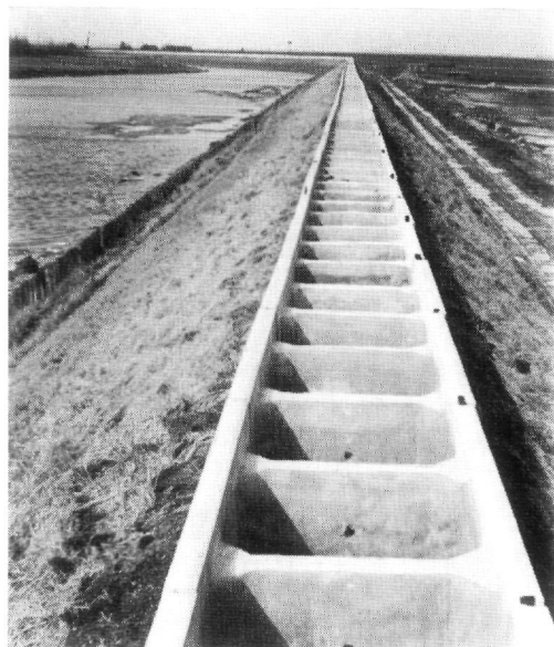
fig. 136. Tijdelijke verhoging van de havendijken te Stavenisse met betonnen „caissons” (afm. 1,80 \times 1 \times 1 m) in uitvoering. De „caissons” werden gevuld met klei en afgedekt met asfalt.
