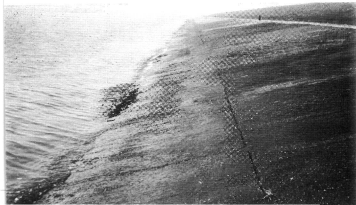
fig. 198. Asfaltglooiing aan de zeedijk bij Ouwerkerk, aangelegd in 1954 (langs het Keeten).
