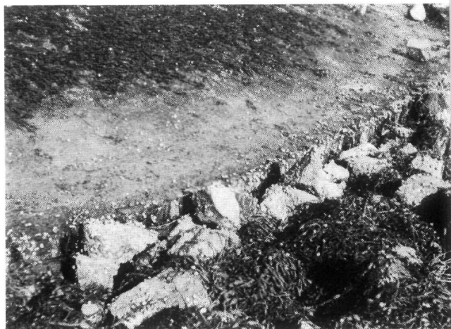
fig. 197. Teenconstructie van de asfaltglooiing aan de ringdijk bij Schelphoek aan de zuidkust van Schouwen.
