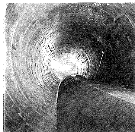
4 Binnenkant afvoerleiding met binnendiameter van 3,70 m, gemaakt volgens het schild-systeem; voorbeeld van enkelschalige tunnelwand Interior outlet with inner diameter of 3.70 m, constructed according to the drum-digging shield method; example of a single-shell tunnel wall
