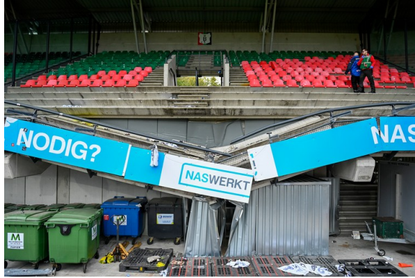
Figure 31: Collapsed grandstand element NEC stadium. Source: https://www.vi.nl/nieuws/ingenieursbureau-doet-onderzoek-naar-ingestorte-tribune-goffertstadion
