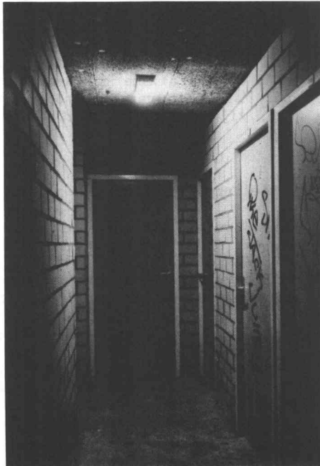
Voorbeeld van bekladde bergingen van de rugwoningen.
