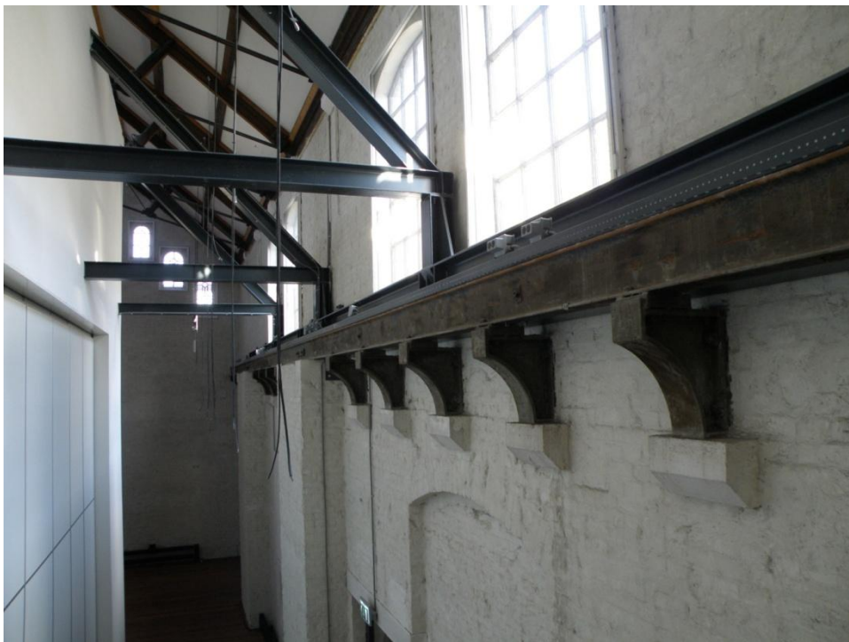
8.7 Monumentale kraanbaan in de zuiveringshal met nieuw spanten Afbeelding: EB
