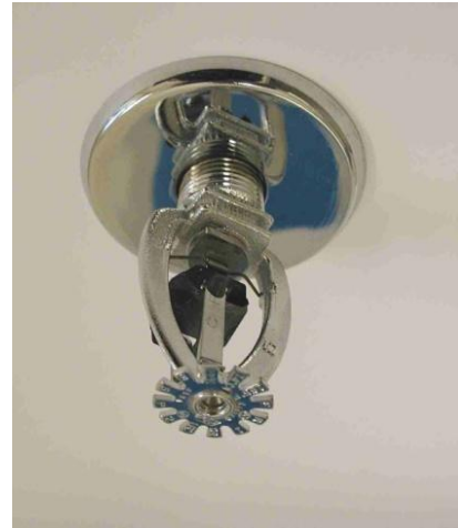
7.8 Voorbeeld van een sprinkler
