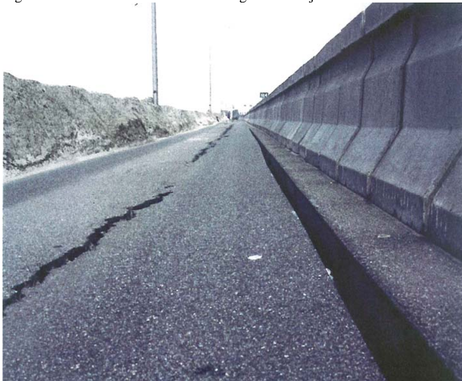
Figuur 1 Schade Case 2A: Verbreding A2 Haarrijn
