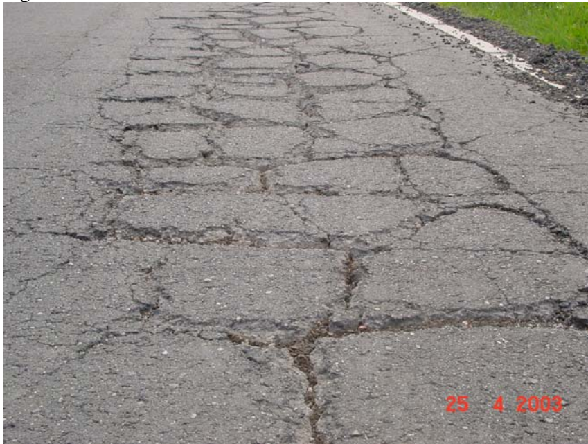
Figuur 6 Schade Case 5B
