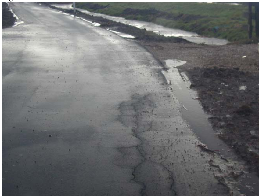
Figuur 5 Schade Case 4B
