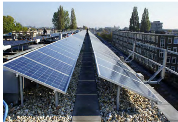
Figure 2-26: PV-panels on the roof of Koningsvrouwen (Archivolt Architecten bv, 2012)
