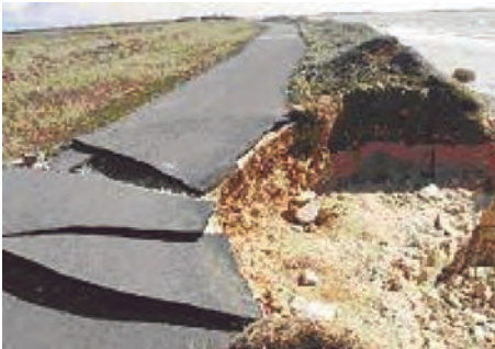
Figuur 19: De promenade van Aytré na de overstroming. [14].
