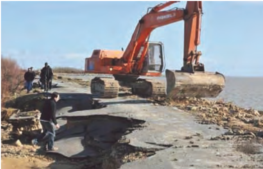
Figuur 15: Door overstroming van de waterkering heeft regressieve erosie plaatsgevonden bij L'Aiguillon-sur-Mer. [15].
