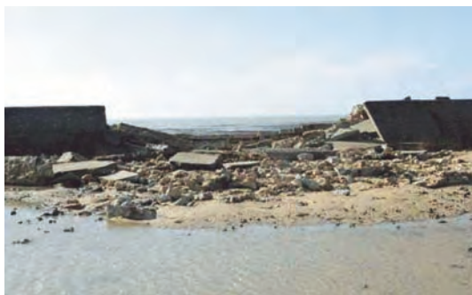
Figuur 21: Doorbraak van een keermuur bij St.-Martin-de-Ré, op het Île de Ré.
