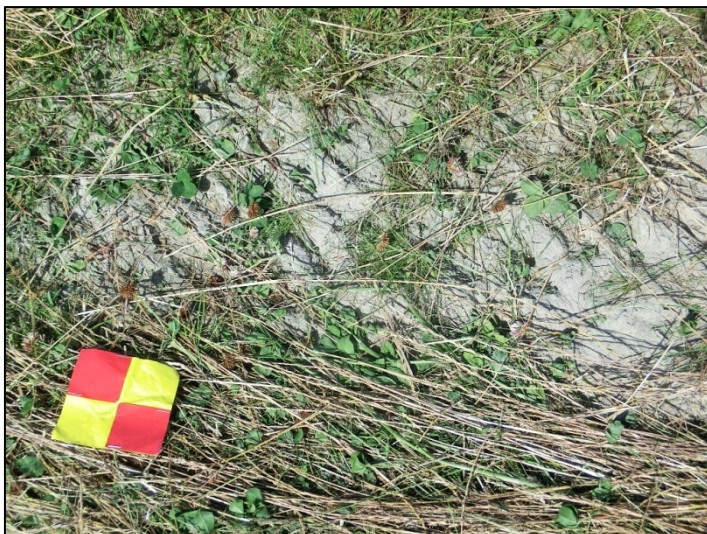
Foto 50. Proefvak 46: tractorspoor op dijktalud.
