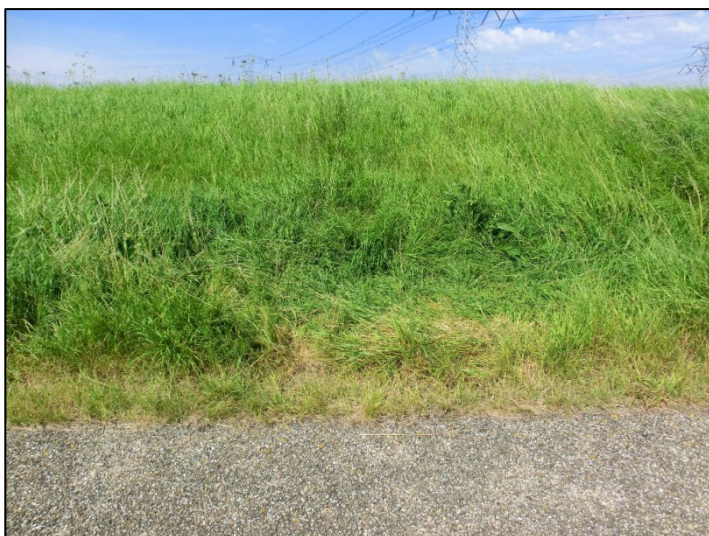
Foto 29. Proefvak 30: stagnatie van zout water mogelijk en mogelijke inkassing van talud.
