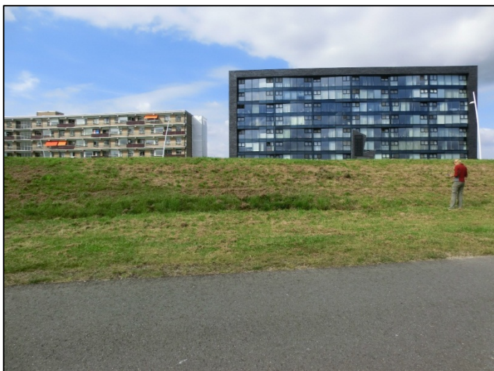
Foto 108. Proefvak 102: randje (mogelijk inkassing) bij knik in talud.
