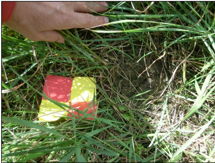
Foto 121. Proefvak 114: grote open plekken, met droogte scheur op dijktaalud.
