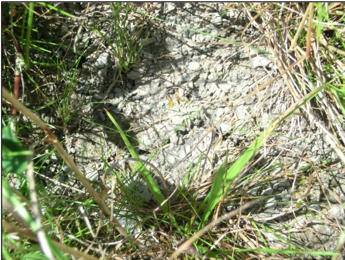
Foto 47. Proefvak 45: kleine droogte scheuren op het dijktalud.
