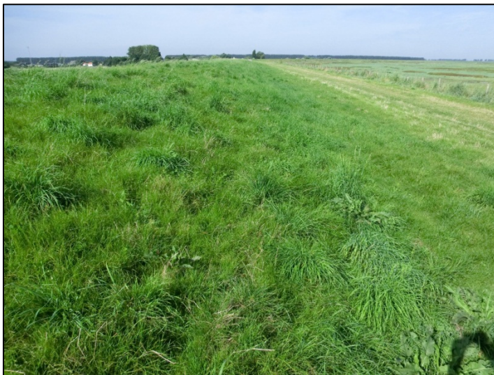
Foto 72. Proefvak 68: flauwe knik onder aan dijktalud.
