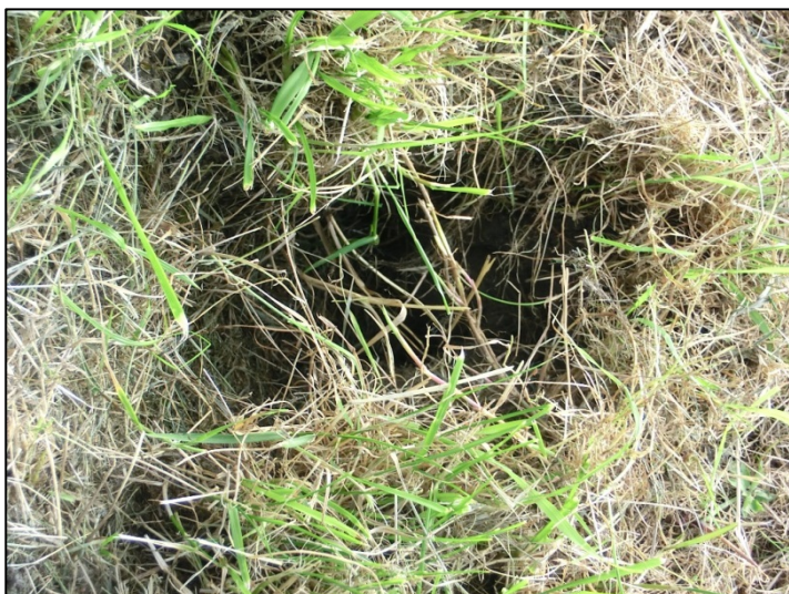
Foto 109. Proefvak 103: gat in dijktalud.
