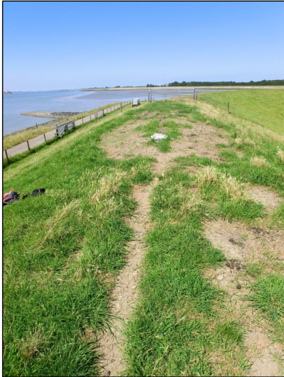
Foto 16. Proefvak 18: plus: kruin van de dijk is erg open.
