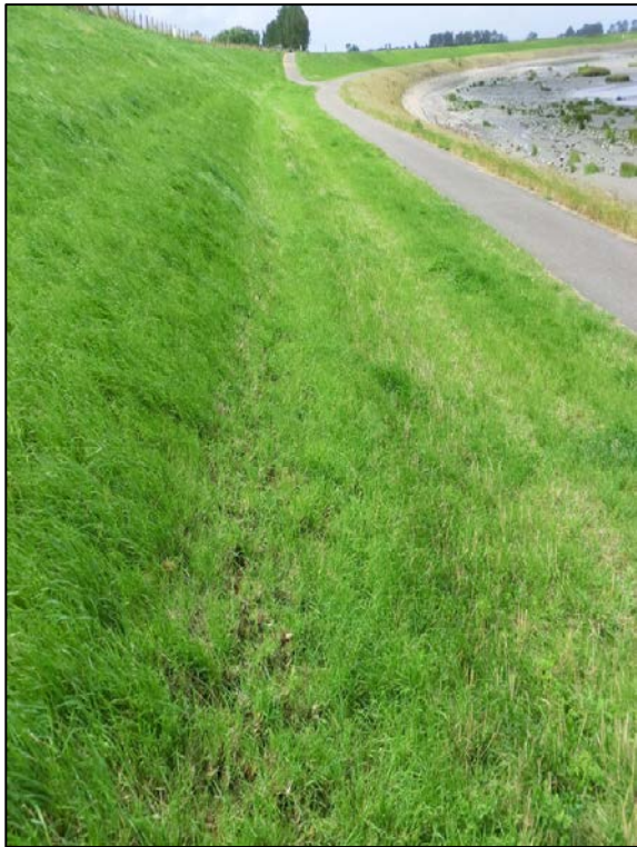
Foto 84. Proefvak 78: zode vrij kaal bij overgang dijkwalud naar dijk voet.
