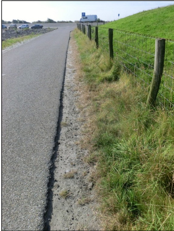
Foto 66. Proefvak 61: kale strook langs onderhoudsweg, hier is stagnatie van zout water mogelijk.
