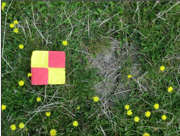
Foto 68. Proefvak 65: droogtescheuren in dijktalud.
