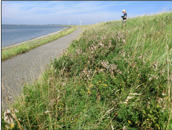
Foto 24. Proefvak 27: veel distels onderaan het dijktalud.
