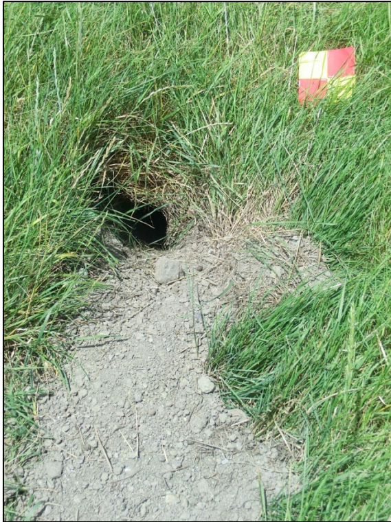
Foto 45. Proefvak 44: dijktalud met hol.
