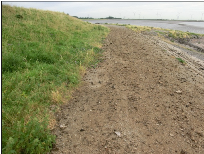
Foto 36. Proefvak 36: onderhoudsweg bedekt met klei, ruige vegetatie op talud.
