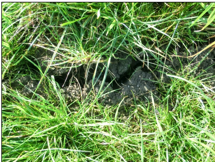
Foto 73. Proefvak 68: droogtescheuren in dijktalud.
