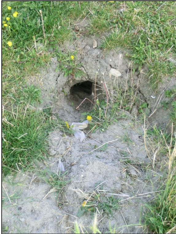
Foto 70. Proefvak 65: hol in dijktalud.
