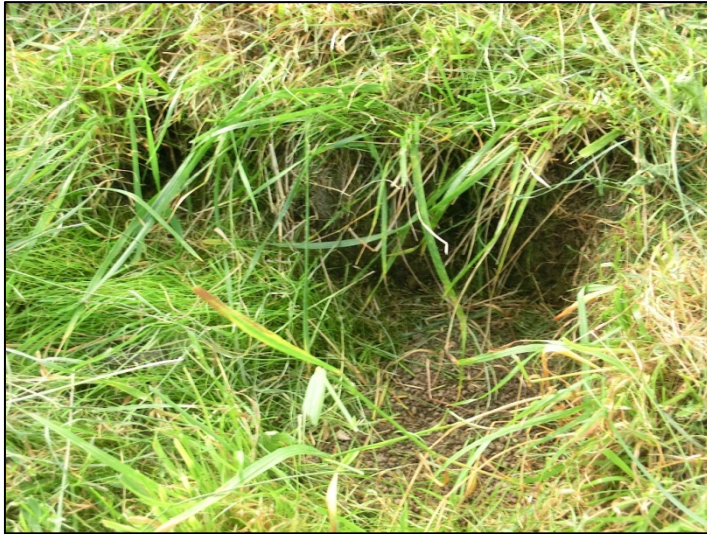
Foto 106. Proefvak 101: gaten in dijkwalud.
