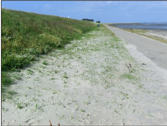
Foto 91. Proefvak 84: inwaai van wit zand op teen van de dijk.
