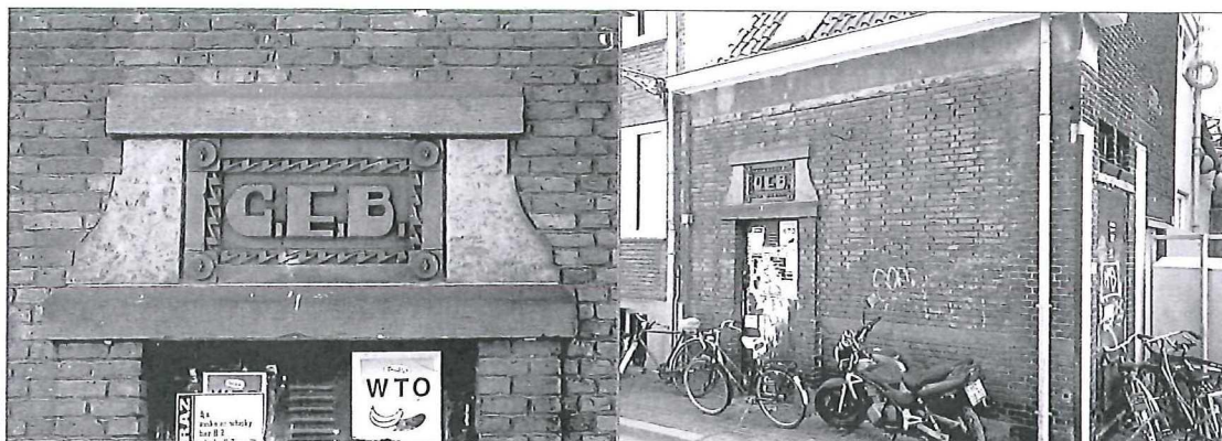
Afbeelding 7 Trafohuisje op het Bagijnhof, met elementen in roodgevlamde Maulbronner zandsteen (Foto's T.G. Nijland, april 2011).
