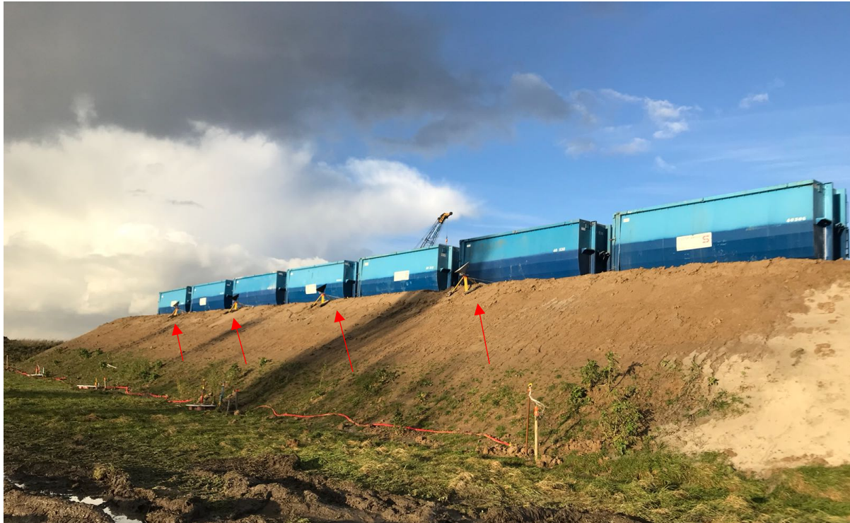
Figuur 6 De 4 geïnstalleerde hoekreflectoren op de groene dijk.
