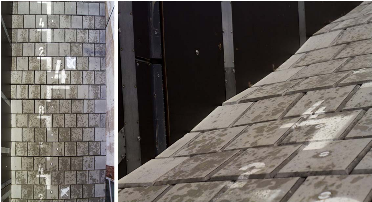
Abbildung 8.23: Darstellung des Abschnitts 1 (Standard Verkalit ® -Deckwerkstein 180°mm) links: Draufsicht auf den belasteten Bereich, rechts: Detailaufnahme des Bereichs um den Schichtdickenpegel DSP1_Z98
