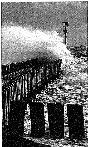
De krachten die bij het breken van golven vrijkomen zijn groot. Bij zware stormen kan de kustverdediging daardoor schade oplopen. De veiligheid van ons land tegen overstromen hoeft dan nog niet in het geding te zijn.
