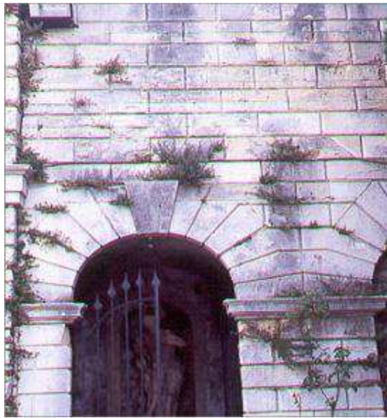
Fig. 13. Villa in Trissino (Vicenza), Italië: pleister op natuursteenblokken (Foto R. van Hees).
