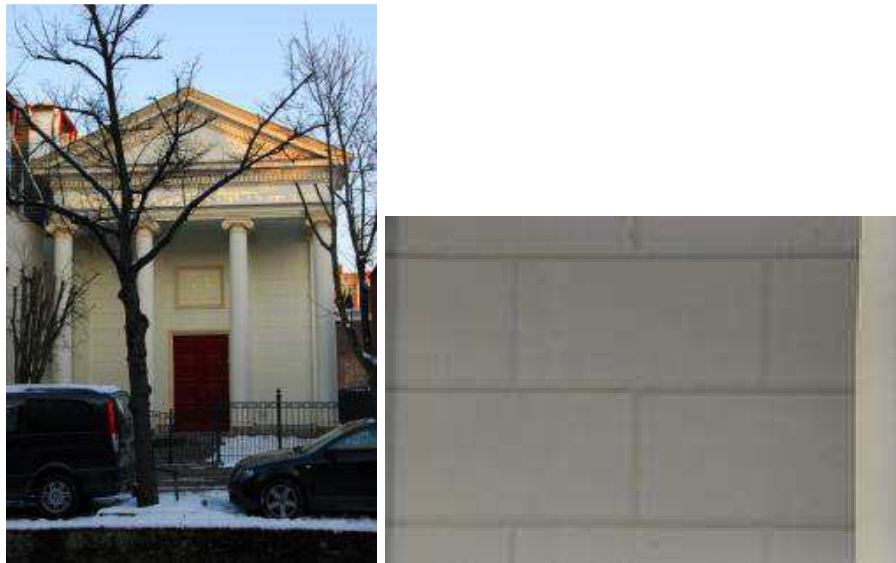
Fig. 18. Synagoge te Delft uit 1862-63 van L. Winkel. Pleister die natuursteen blokken suggereert.
