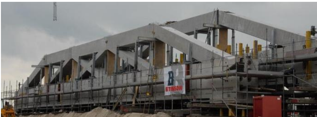
Figuur 5-7 een foto van de vakwerkconstructies van de spoorbrug over de Dieze in aanbouw.
