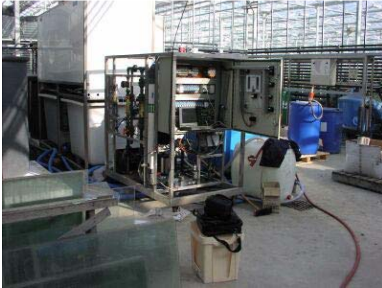
Figuur 5.4: Proefinstallatie met open schakelkast
