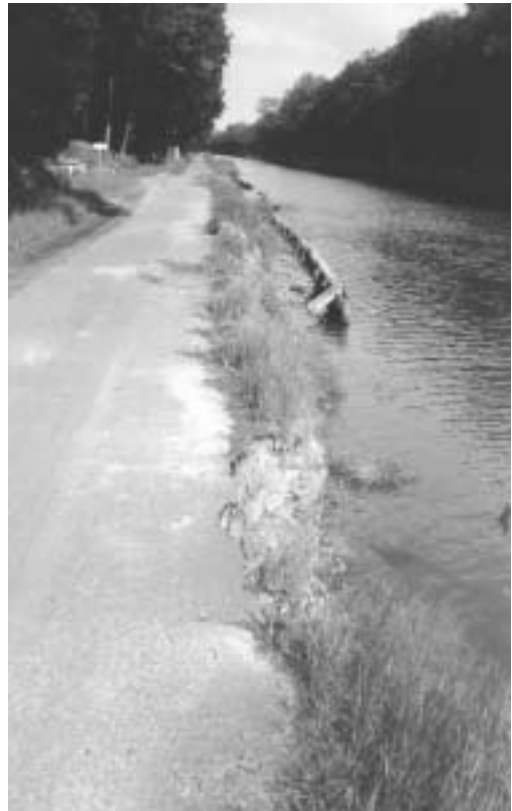
Foto 2.2: Beschadiging weg en dijk
