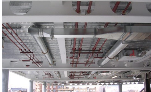
Figuur 38: Duidelijke verdeling van de installatievoorzieningen (BVA 2015)
