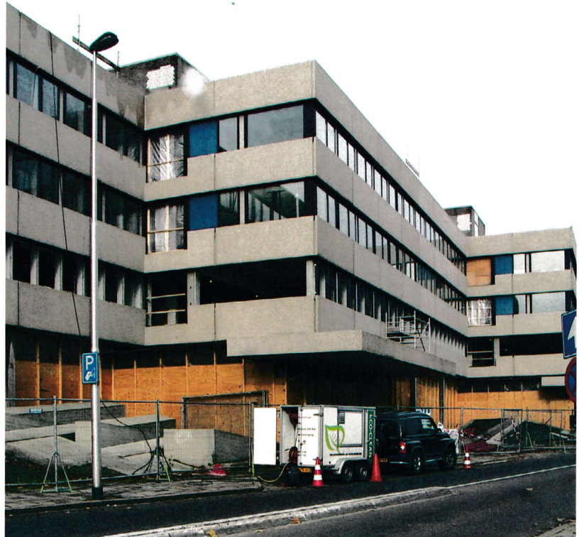
Het belastingkantoor dat gerenoveerd wordt om te worden toegevoegd aan het Paleis van Justitie in 2005 | Foto H. Zijlstra
