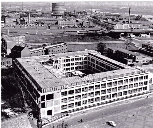
Het nog in aanbouwzijnde Paleis van Justitie | Bron: NAI SEVZ, foto J. Jansen Nieuw Vennep
