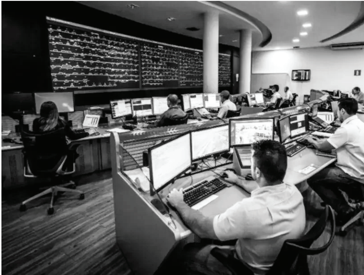
TIPLAM VLI, Cubatão control room
