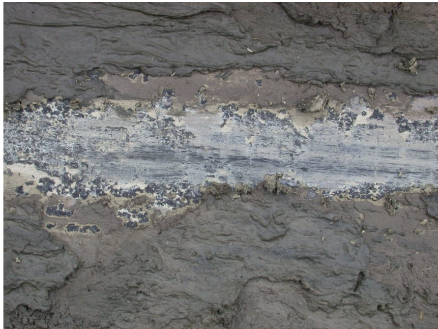
Figuur 4. Detail van de damwandsectie bedekt met een kleiachtige laag met in het midden gereinigde strook met resten wit/grijze afzetting.
