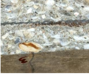
Crack position N°3
