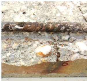
Crack position N°6
