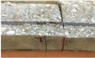
Crack position N°2
