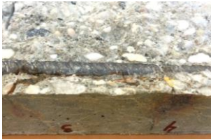
Crack position N°4
