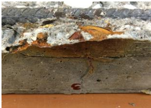
Crack position N°3
