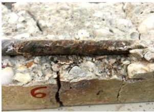
Crack position N°9
