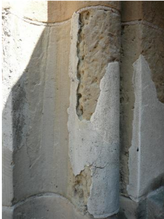
Fig. 7. Natuursteenreparatie; na enige tijd is scheurvorming en onthechting opgetreden (zandsteen).
