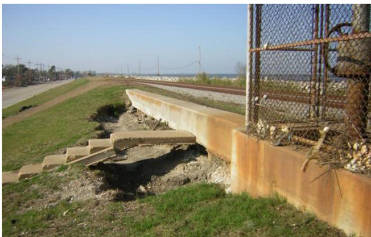
Figuur 3.1 Erosie bij overgang van betonnen rand naar dijk (foto: Rune Storesund, bron: Pijpers, 2013)
