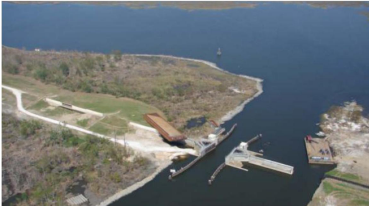
Figuur 3.2 Erosie bij aansluiting kunstwerk en dijk (foto: Les Harder, bron: Pijpers,2013)
