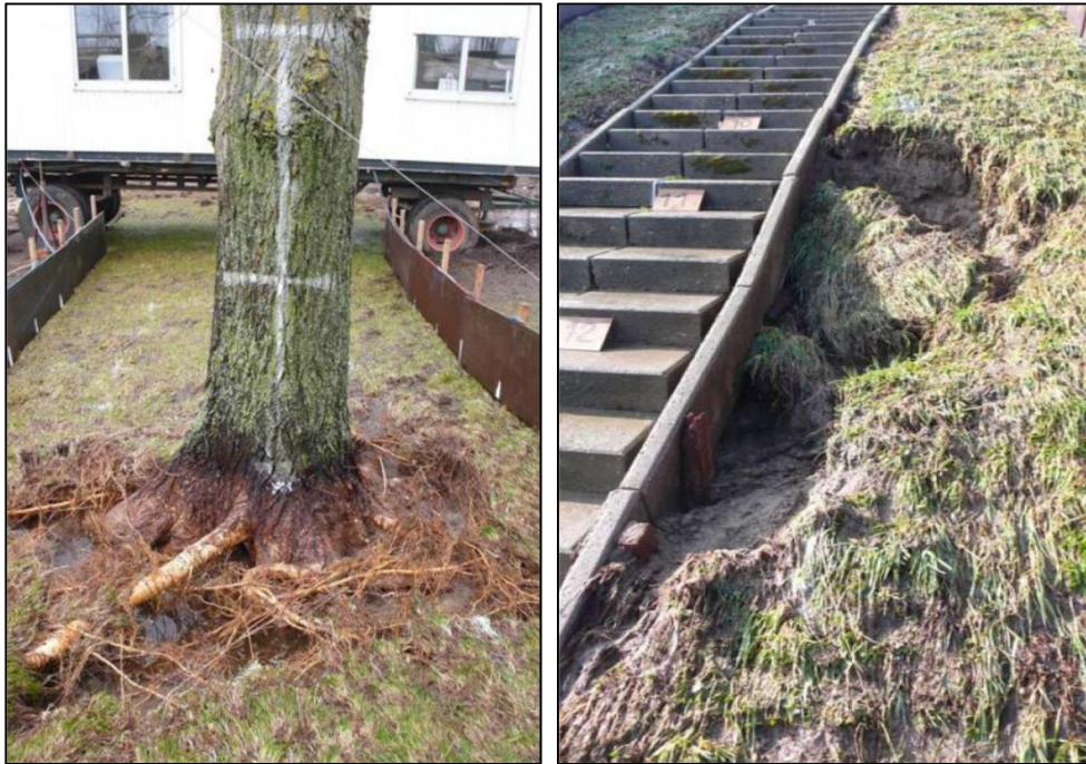
Figuur 4.4 Situatie na het testen met de golfoverslagsimulator. Links: boom in grastalud (bron: Pijpers, 2013), rechts: overgang van gras naar trap (bron: Rijkswaterstaat, 2012)
