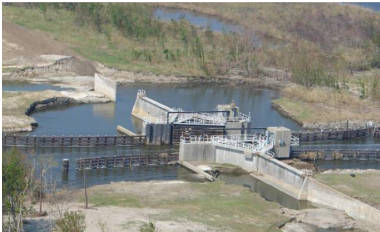
Figuur 3.3 Erosie bij aansluiting kunstwerk en dijk (foto: Les Harder, bron: Pijpers,2013)
