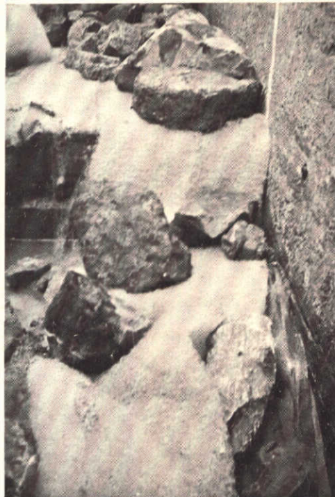
T5 schade na de maximale fase (gezien in bovenstroomse richting)
