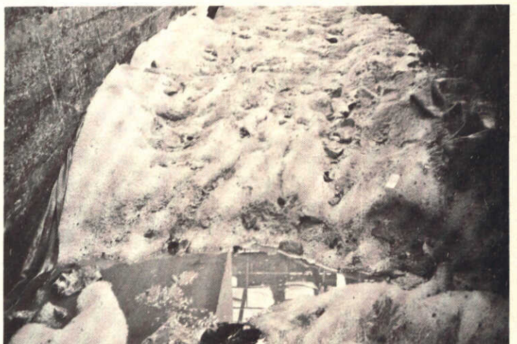
T5 schade na de maximale fase (stortsteen verwijderd)
