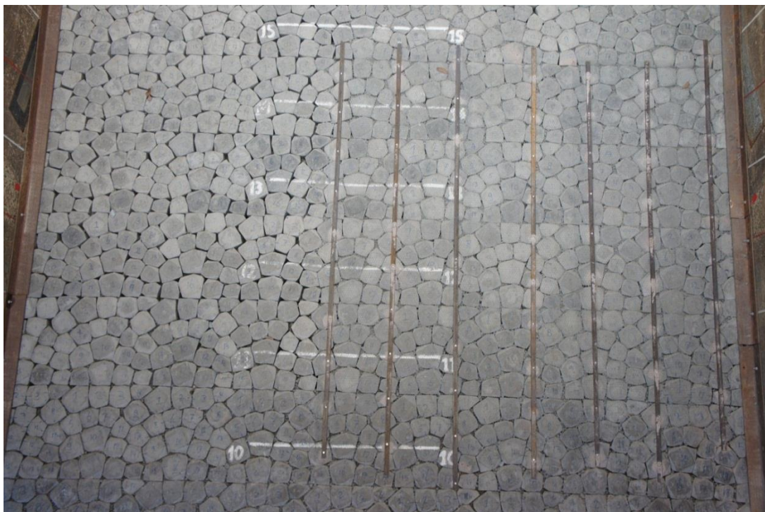
Figuur 4.9 Resultaat na het herstellen van de schade aan meetcabinezijde na Proef 9
